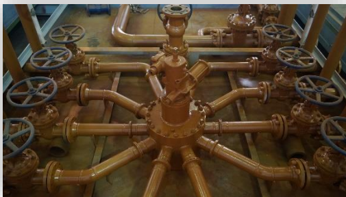
АВТОМАТИЧЕСКАЯ ГРУППОВАЯ ЗАМЕРНАЯ УСТАНОВКА (АГЗУ)
